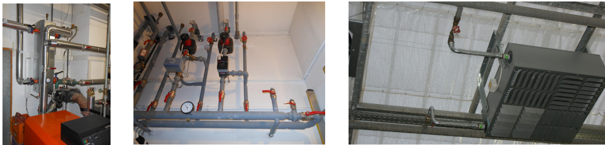
Abbildung 4-2: Hydraulische Weichen (links), Hydraulische Kurzschlüsse (mitte), Luftheizer-Anbindung ohne Rücklauf-temperaturbegrenzung (rechts); Bildquelle: ZTL, 2011
