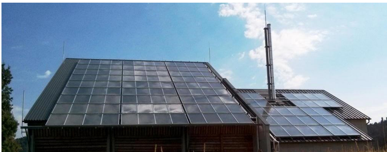
Abbildung 3-13: Ansicht des 350 m 2 großen Kollektorfeldes am Dach des Heizhauses bzw. Hackgutlagerraumes der Anlage „Nahwärme Großklein“, Bildquelle AEE INTEC
